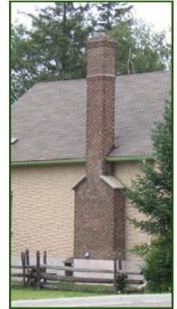
Les cheminées extérieures ne fonctionnent pas bien.
